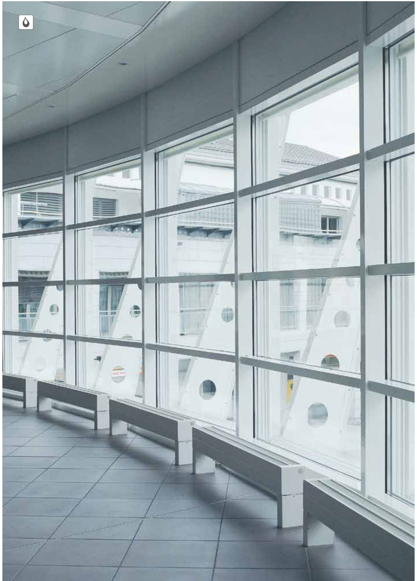
Heizkörper-Farbe: Traffic White
