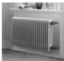
Vorher: Alter Heizkörper
